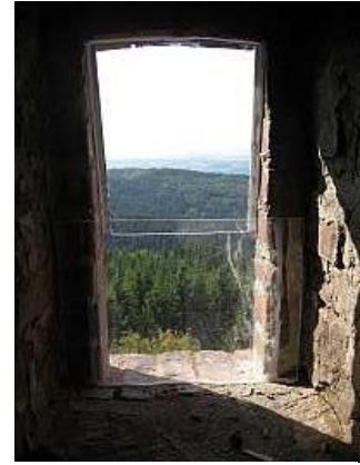
Es wurden mehrere Maßnahmen um das Eindringen von Niederschlägen zu reduzieren. Hier: versetzte Scheiben
